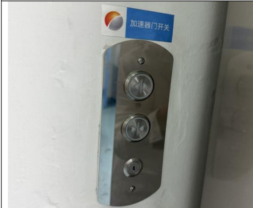
加速器机房门外钥匙开关
