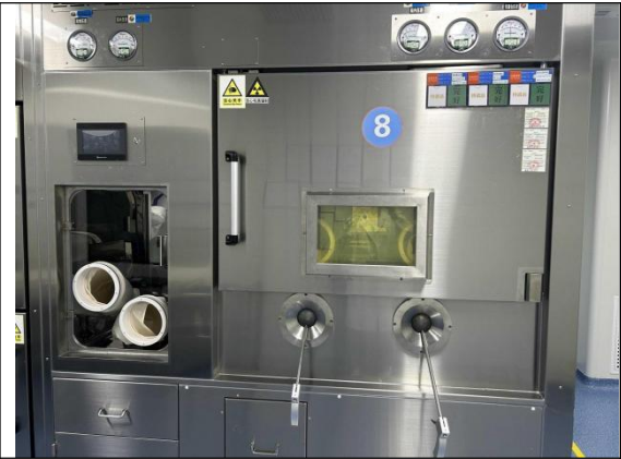
生产车间二分装模块箱
