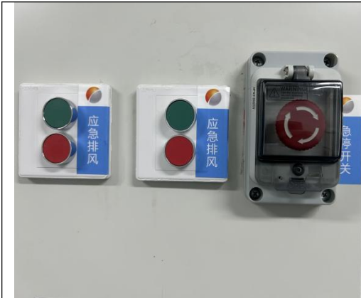
加速器控制室急停开关
