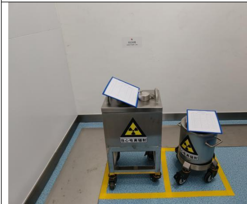
加速器机房内放射性废物收集桶
