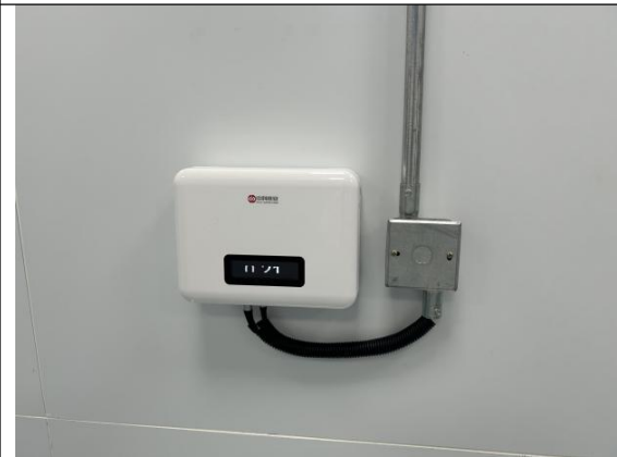
加速器机房固定式 X-γ 辐射监测仪
